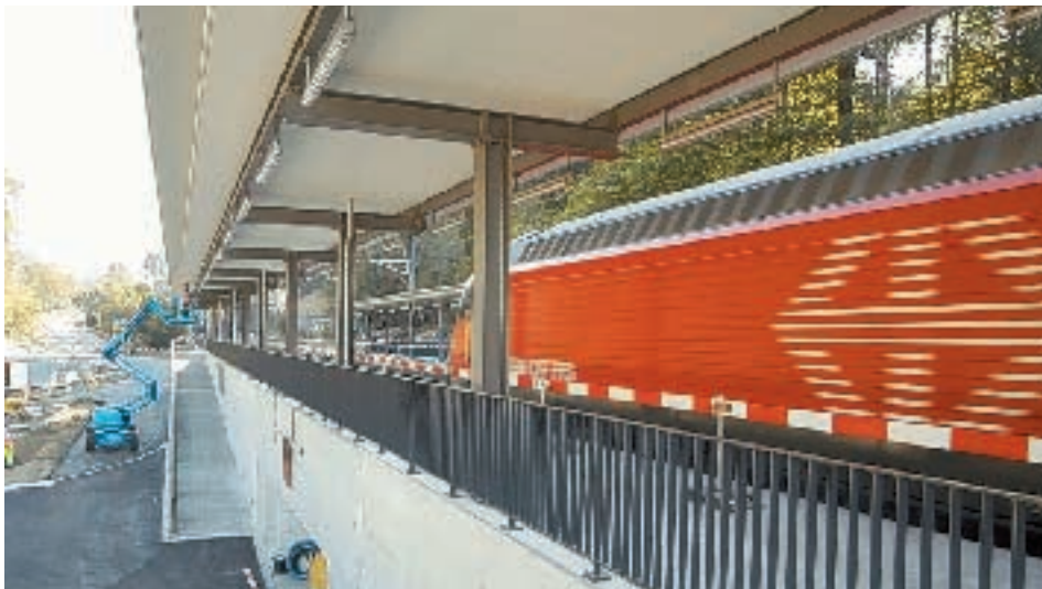
Bis zum 12. Dezember muss die neue Haltestelle Mellingen-Heitersberg bereit sein. WALTER SCHWAGER
